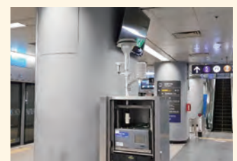
韓国向けPM2.5測定装置 FPM-388型 (地下鉄構内設置例)
